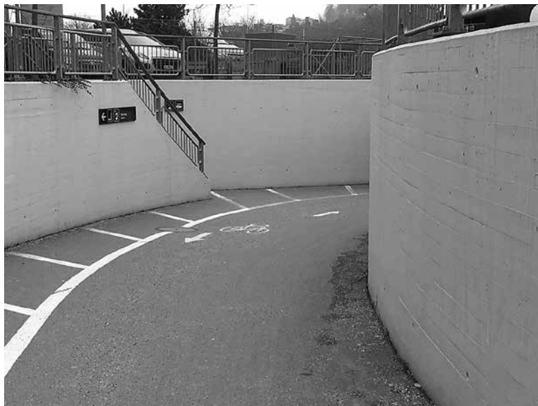
Die Sichtverhältnisse in der als eine der Ersatzrouten angedachten Unterführung Brändi sind ungenügend. Nach der Kurve hat es nochmals zwei seitliche Zugänge.
